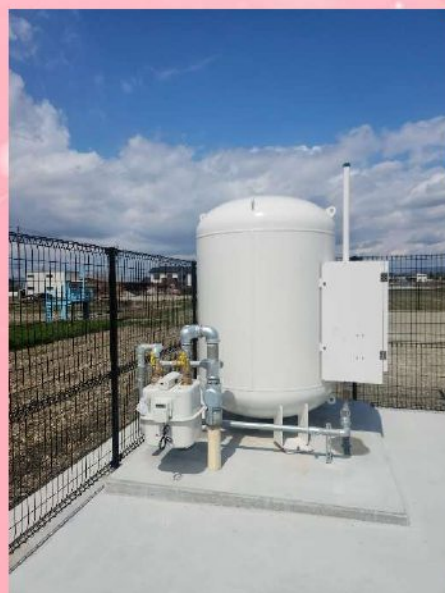
LPガスタンク
